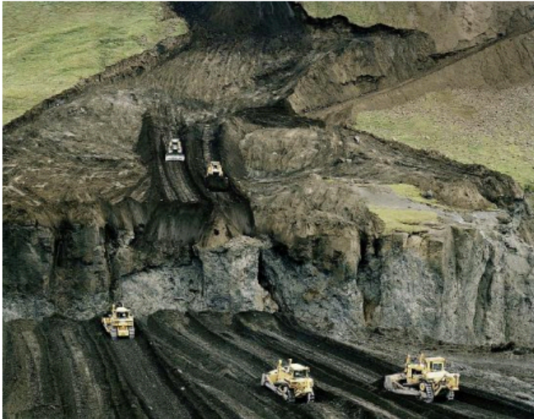
Fast schon groteske Umtriebe: Bau des Kárahnjúkar-Kraftwerks in Pétur Thomsens Serie «Imported Landscapes». Foto: zvg
